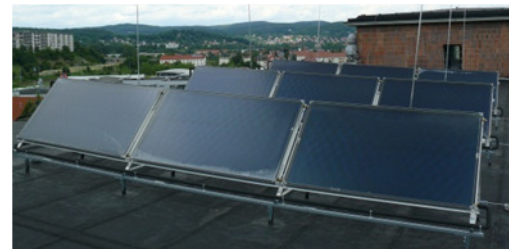
Solarthermieanlage im TITK
