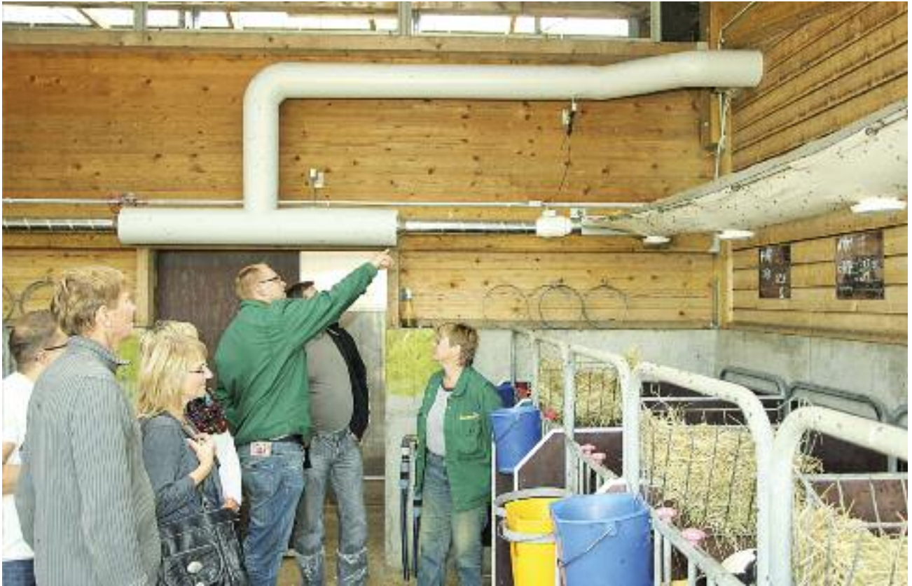
Kälberaufzuchtbox mit darüber installierter textiler 3D-Lufttemperiermatte.
