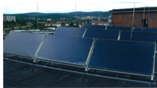
Solarthermie-Paneele auf dem Dach des TITK e.V. zur Speisung der Demonstrationsanlagen mit solarer Wärme
